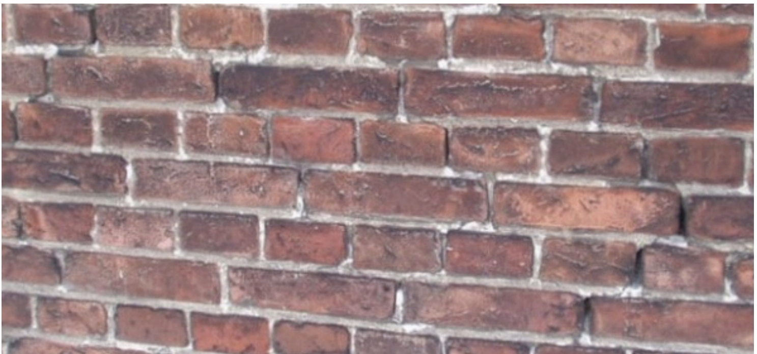
Manglende eller porøs murværk skal efterses og reparereres
